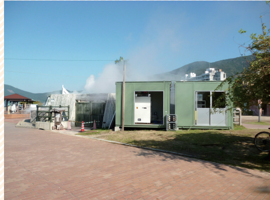
【小規模バイナリー発電機の様子】
