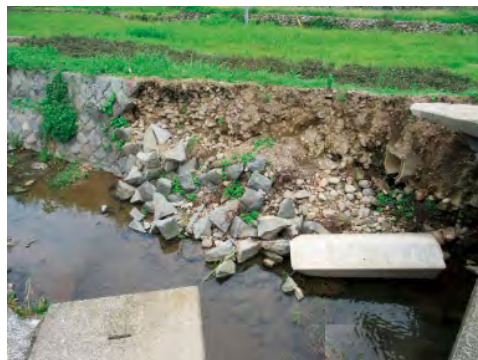
吾妻町井流地区の被災状況
