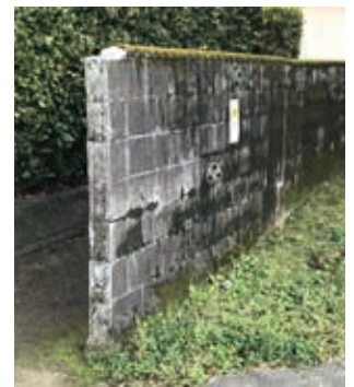
危険ブロック塀
