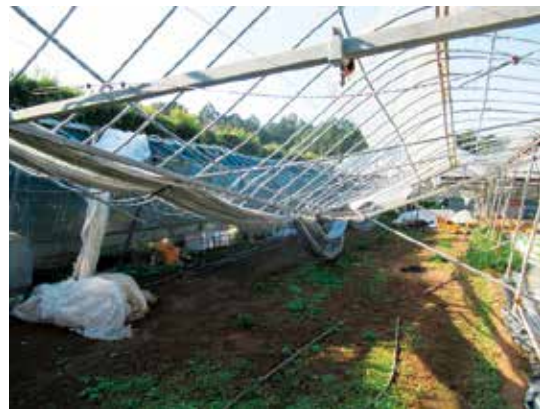
被害を受けたビニールハウス
