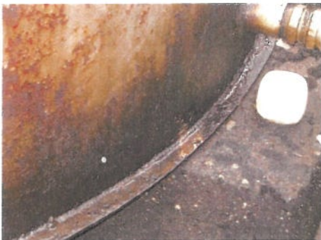
①. 重油タンクの腐食
