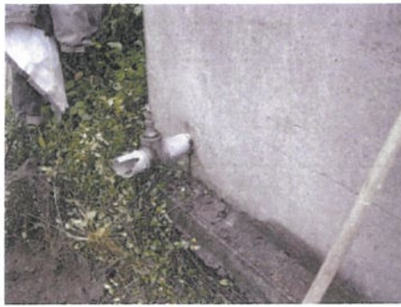
②. 防油堤のひび割れとバルブ
