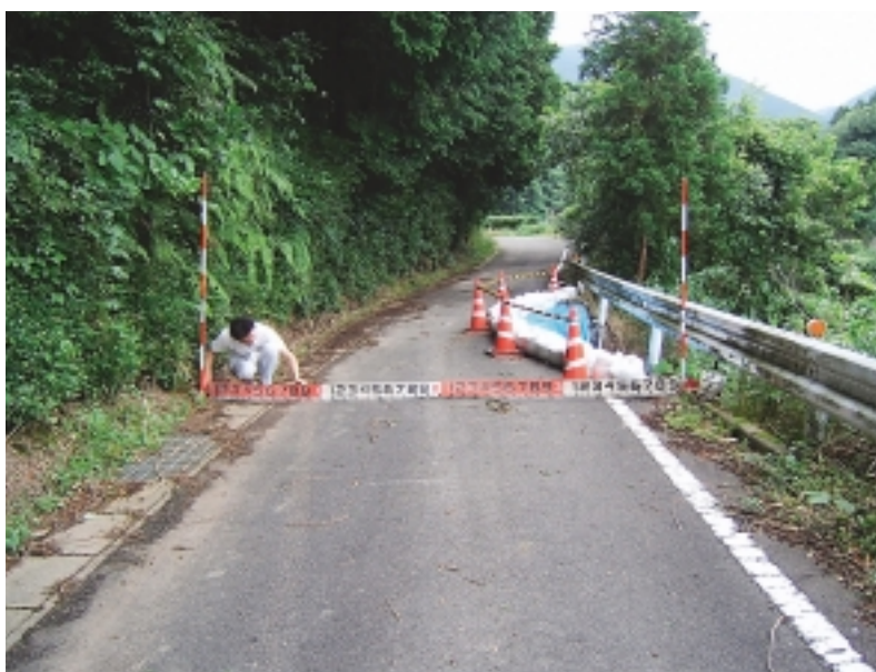
6月26日の豪雨により道路路肩が崩壊した市道国見新魚洗川線
