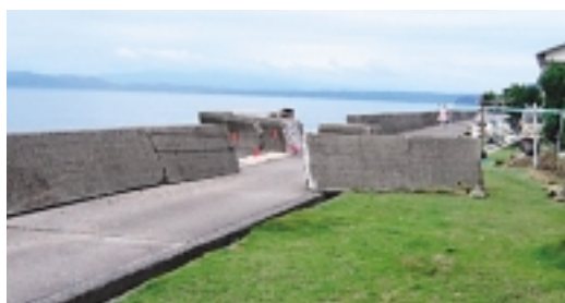
台風13号により破壊された金浜海岸護岸堤
