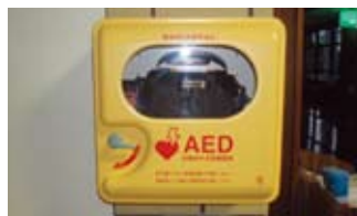
↑ 吾妻町ふるさと会館に設置されたAED
