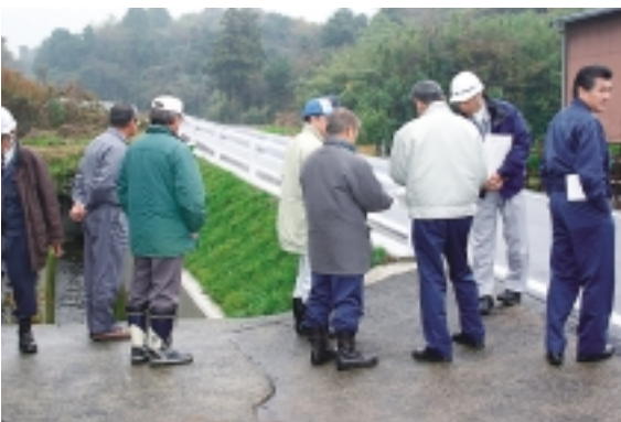
市道吾妻横山線【ガードパイプ破損現場】（吾妻町）
