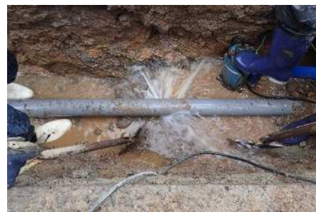
<写真> 管路からの漏水
