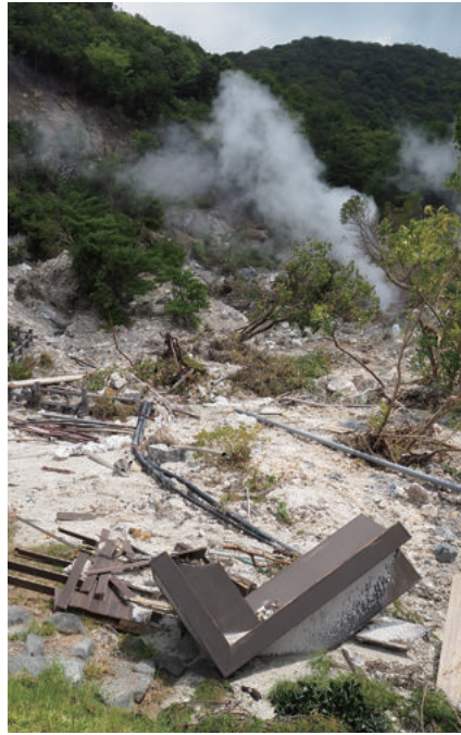
土砂に埋もれた配管や休憩所 ＝八万地獄
