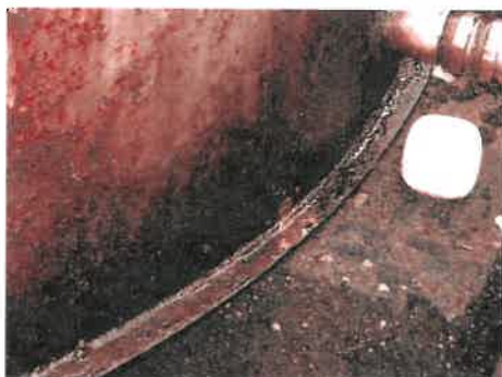
①. 重油タンクの腐食
