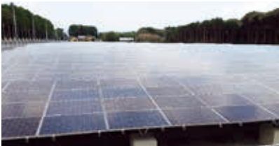
太陽光パネル
